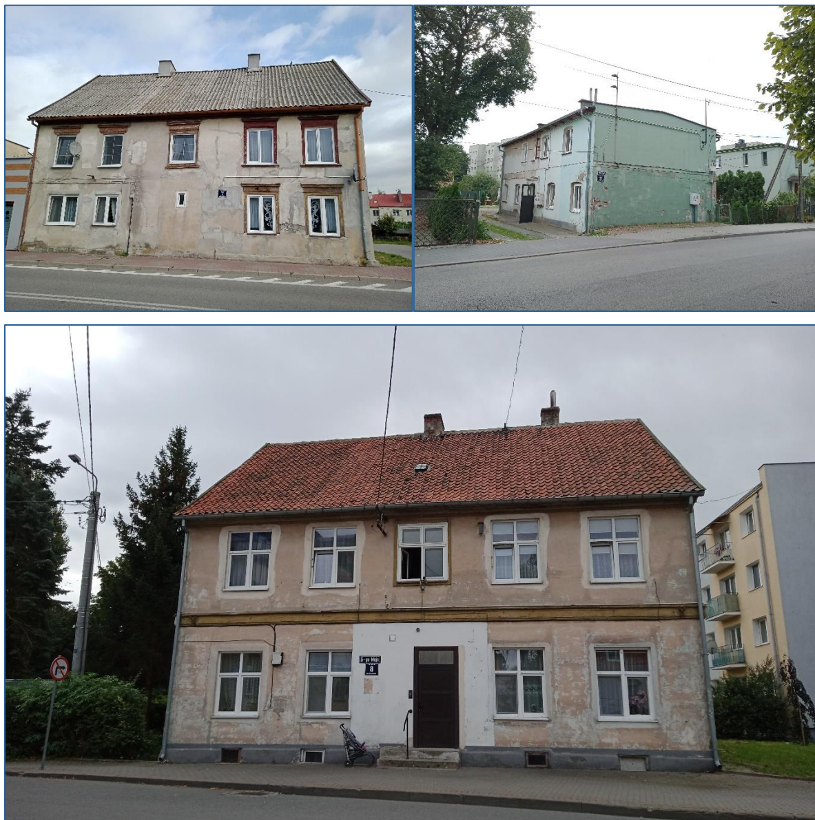
Ryc. 25 Przykłady zdegradowanej infrastruktury mieszkaniowej w Nowym Dworze Gdańskim: ul. Henryka Sienkiewicza 7, ul. Michała Drzymały 11, ul. 3-go Maja 8
